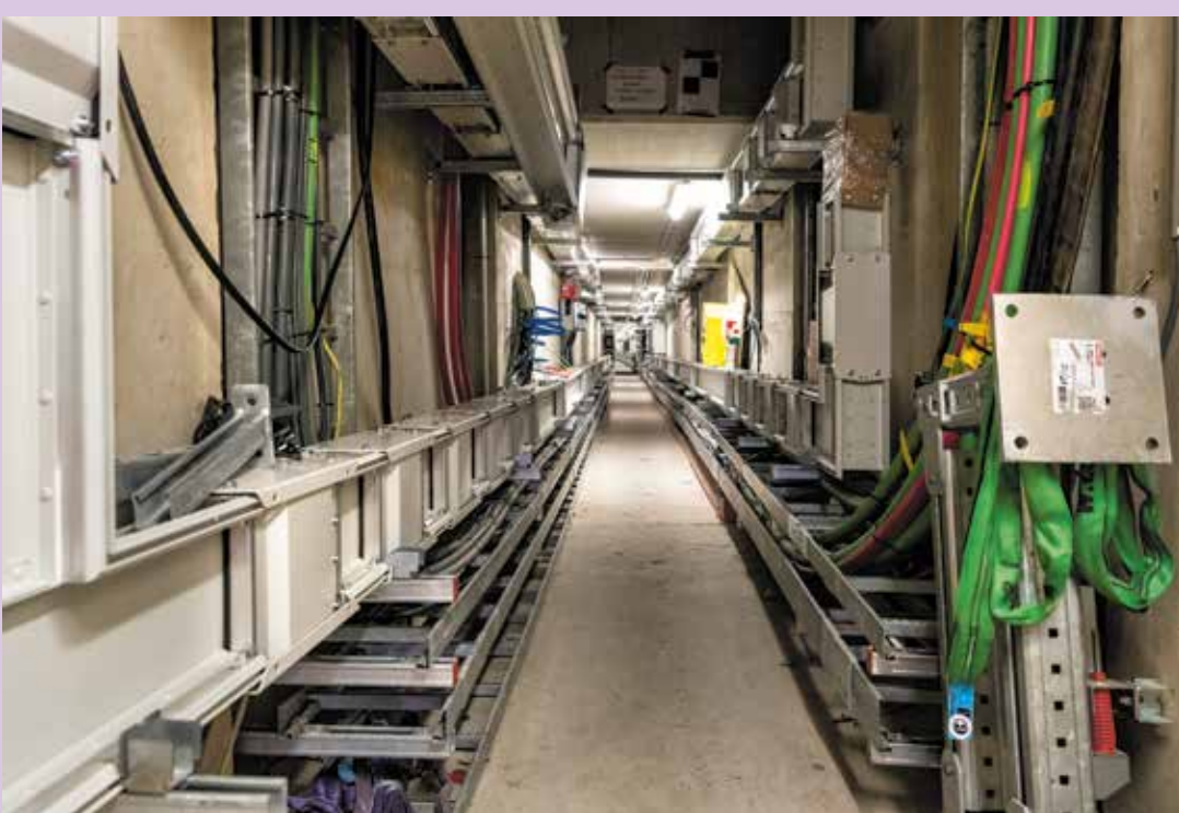
In het middentunnelkanaal (de ruimte tussen de twee rijbuizen in de tunnel) bevindt zich de vluchtgang met daarboven de dienstgang. De dienstgang is te zien bij de stijgschacht naar het dienstgebouw Oost.
