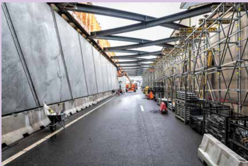
Links zijn de betonnen voorzetwanden te zien. Aan de rechterzijde wordt de steiger opgebouwd voor het vervangen van het stempelraam. Dat is de verstevigende constructie boven de tunnelingang aan de oostzijde.
