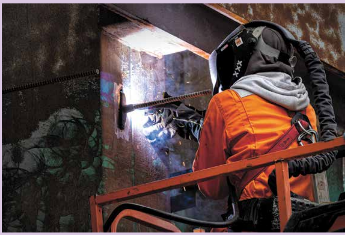
Hier is iemand bezig met het lassen van bevestigingspunten op de bestaande damwand ten behoeve van de voorzetwanden die worden geplaatst.
