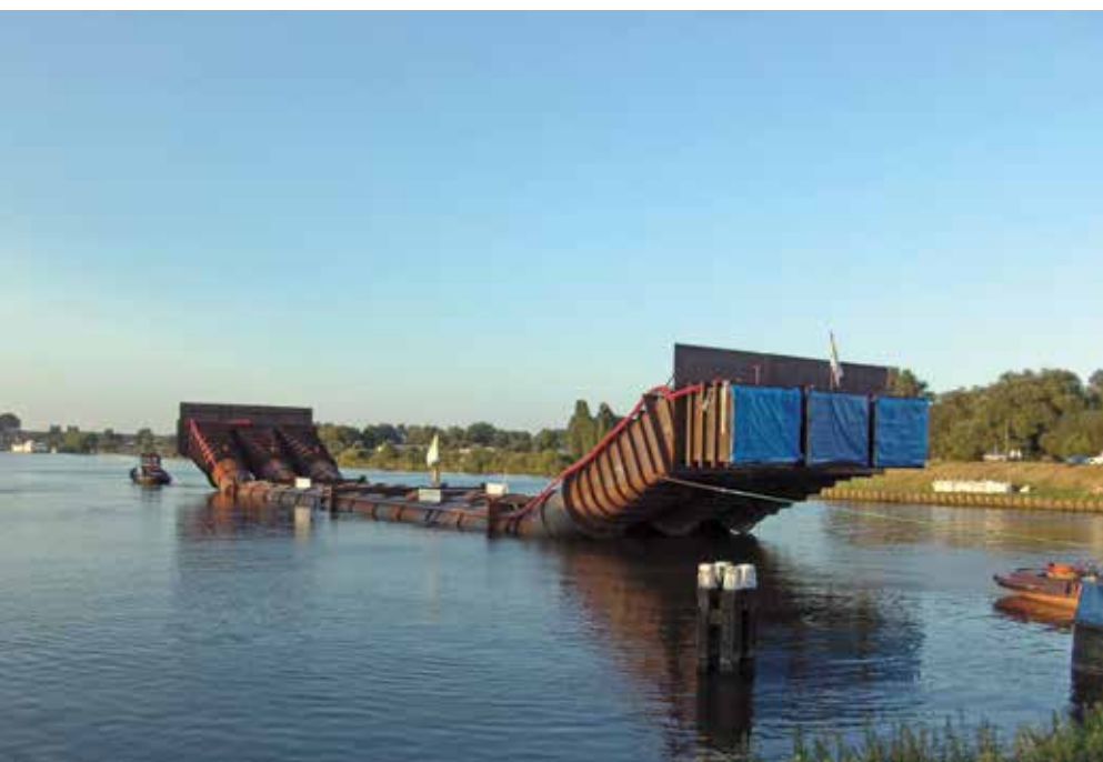
In 2006 werd een nieuwe sifon geplaatst in het Amsterdam-Rijnkanaal. Via de sifon kan het gemaal water spuien in het IJmeer, of water inlaten in Amsterdam
